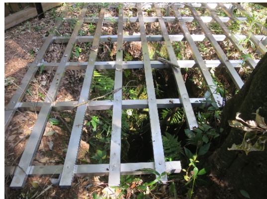
アルミ格子で蓋された深井戸 深さ約6.5m
