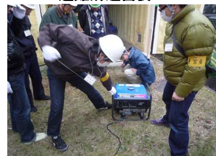
自家発電機の操作(夜間照明対策)
